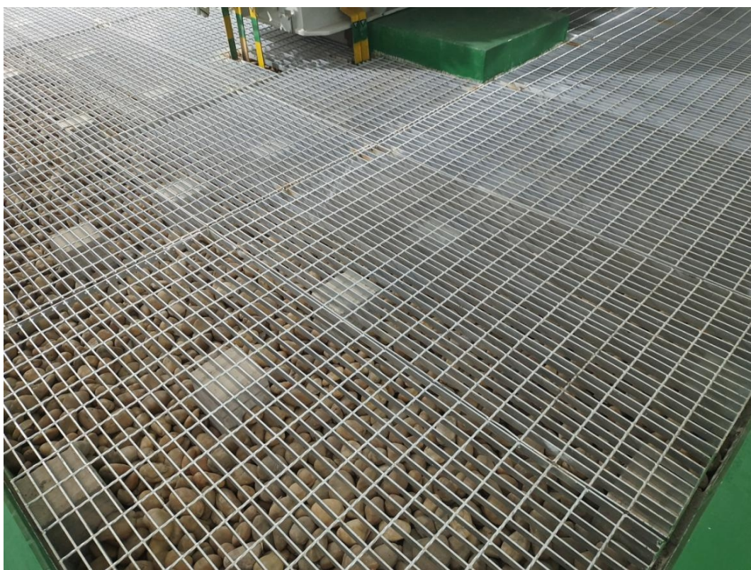
主变压器下方事故油坑
