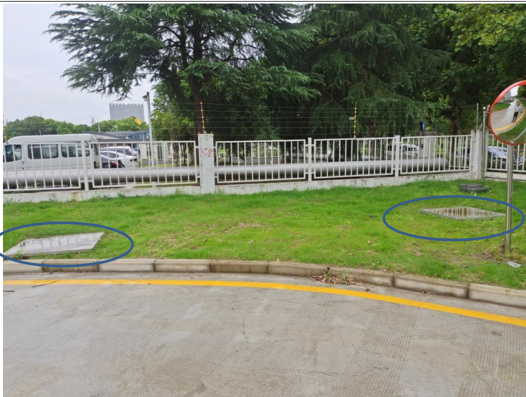
变电站南侧事故油池
